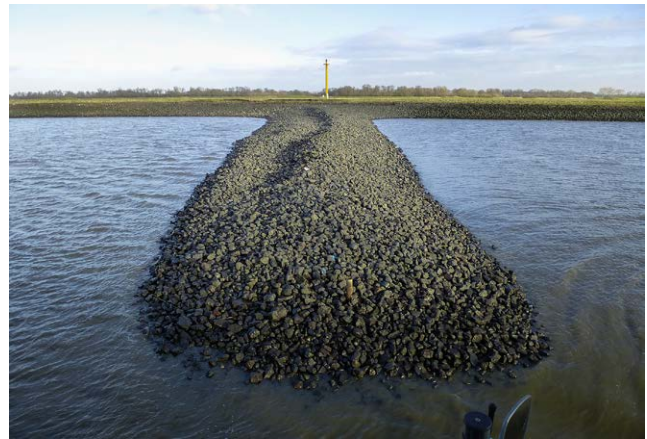
Abb. 1: Schäden links der Buhnenkrone trotz optimierter Bauform und -weise der Buhnen (Dezember 2014)
