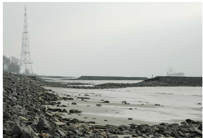
Abb. 2: Durchbruch der Buhnenwurzel bei Juelssand infolge schiffserzeugter langperiodischer Wellenbelastung
