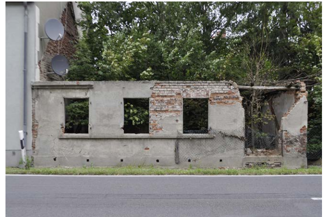
Abb. 2: Bauliche Anlage ohne Bestandsschutz
