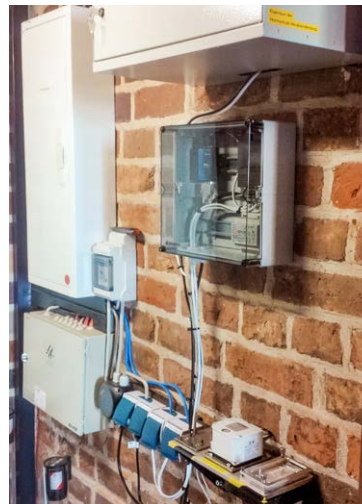
Abb. 6: FreeBSD-Server, Sensor-Steuerungseinheit und Leica Nivel210 auf einer Konsole im Kirchturm
