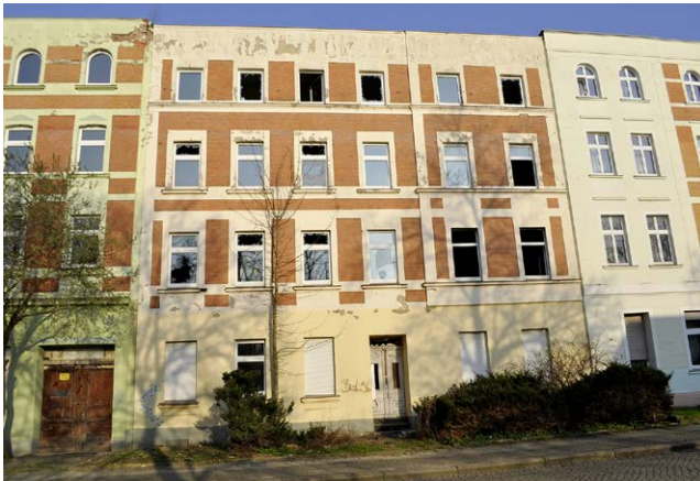
Abb. 2: Dauerhaft leer stehendes Gebäude ohne Bestandsschutz
