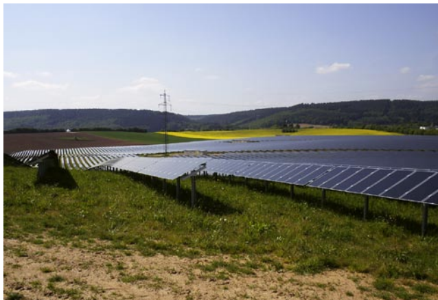
Abb. 1: Solarkraftwerk im Industriepark Region Trier (IRT). Auf einer Fläche von rd. 25 ha produzieren 113.000 Fotovoltaik-Module eine elektrische Leistung von rd. 1 MW (= 5000 t CO 2 -Einsparung pro Jahr).
