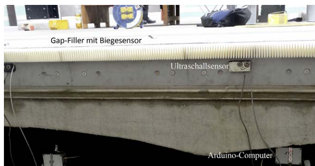
Abb. 2: Blick vom Gleis zum Bahnsteig während des Umbaus. Zu erkennen sind die Gap-Filler an der Bahnsteigkante, die Ultraschallsensoren (kleine Gehäuse unter den Gap-Fillern) und die weitere Hardware (Gehäuse unterhalb des Bahnsteiges).
